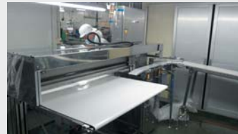
食品自動整列機制御盤
